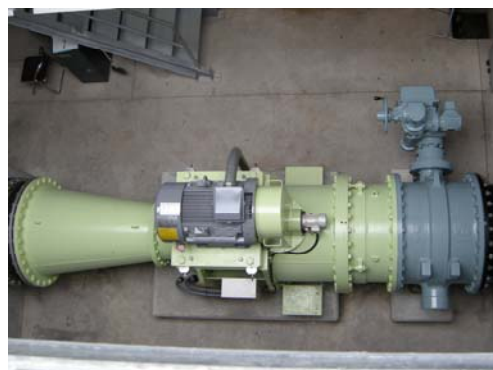
川の段差を利用した小水力発電機
